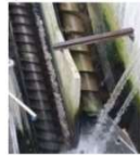
Feuchttücherverschmutzung in der Kläranlage
