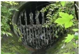
Feuchttücherverschmutzung am Auslass des Regenüberlaufbeckens Waldsiedlung
